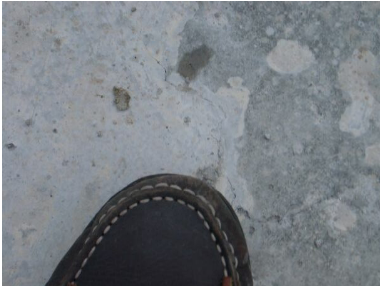
Figur 4.2 Dagen efter gjutning kunde ett millimetertjockt skinn och synliga porer över delar av bottenplattan observeras. Eftersom bottenplattan i förväg hade planerats att ABS-slipas medförde detta ej några negativa konsekvenser för varken produktionsekonomin eller den färdiga konstruktionens funktion.
