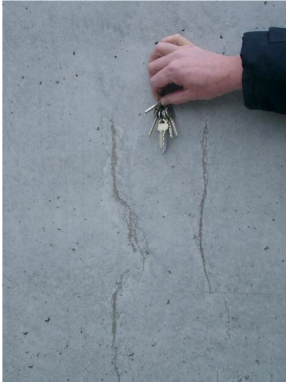
Figur 4.12 Även s.k 'grusränder' kunde observeras på några väggytor.
